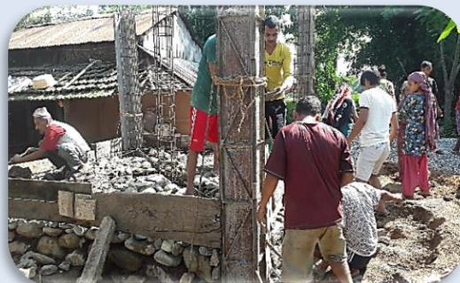
Opbouw voor tanks en zonnepanelen in Jutpani.
